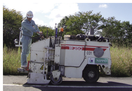
写真-5 センター対応型機全景
