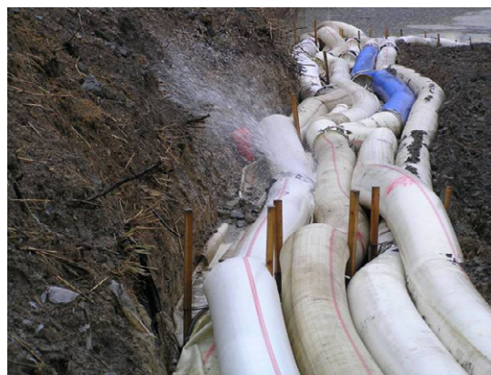
写真－3 緊急排水路に設置されたφ400mm6本のホース
