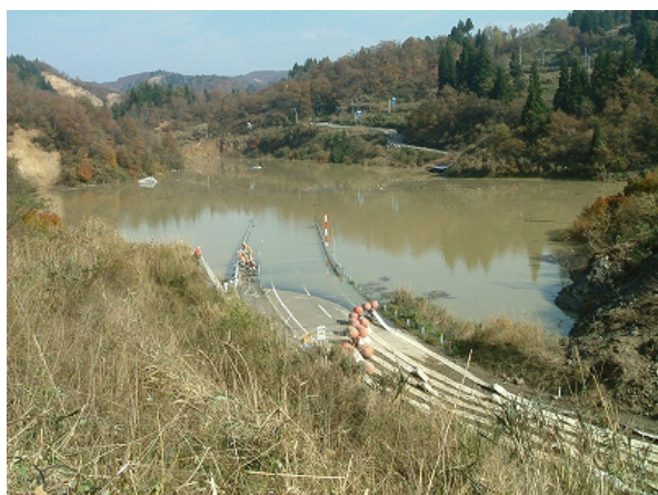
写真－2 水位の上昇前に据付けられた排水ポンプ
