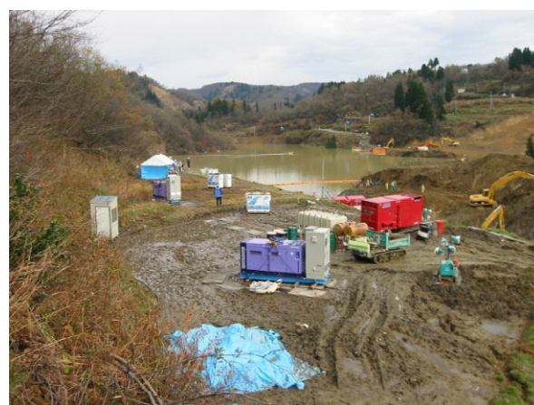
写真－4 田畑に点在した制御盤・発動・燃料タンク
