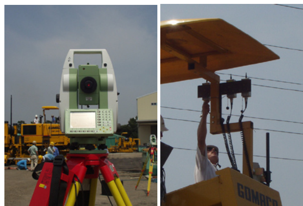
写真-3 TS・無線通信機器
