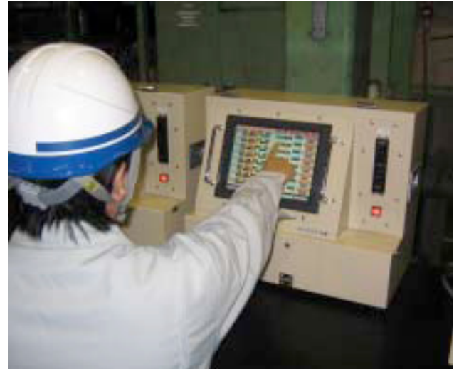
図-6 集中管理装置と操作状況
