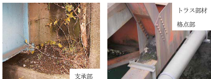
写真-1 土砂詰りによる損傷例
