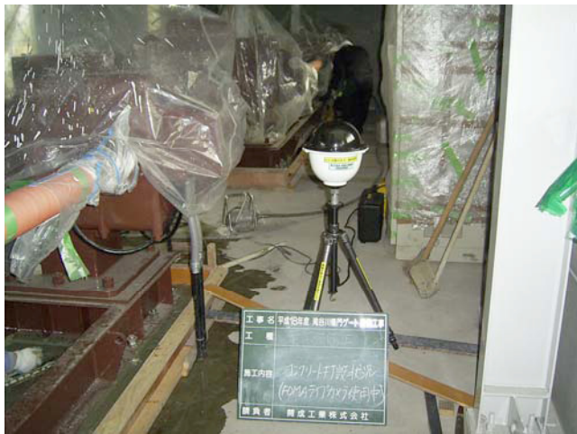
写真-4 現場におけるシステム設置状況
