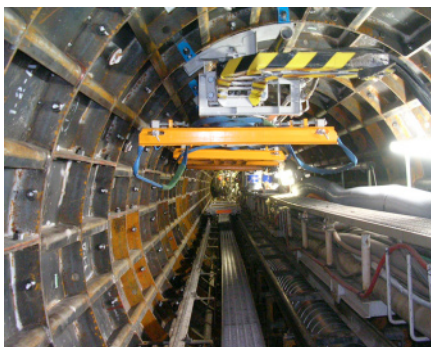
写真-5 台車部荷受け装置(待機時)
