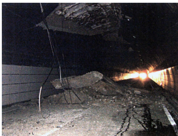
写真－1 コンクリートの剥落
