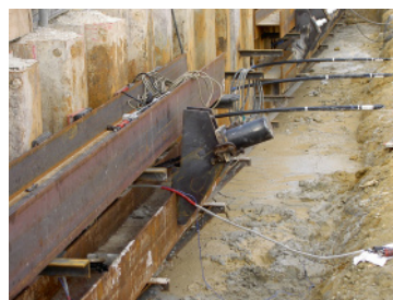
写真－4 通電状況
