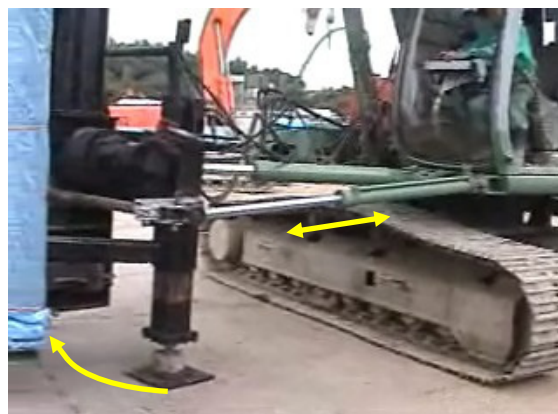
写真－4 リーダー首振り用ジャッキ
