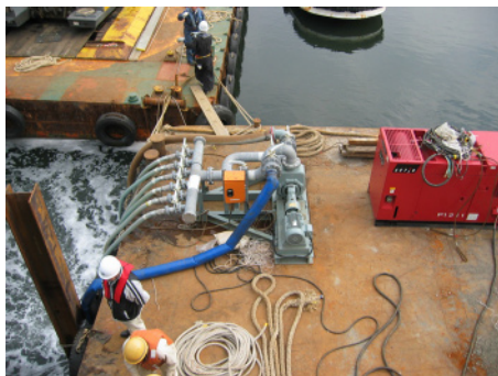
写真－7 給排水設備
