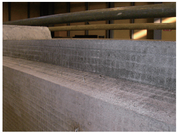
写真-6 目地部脱枠状況
