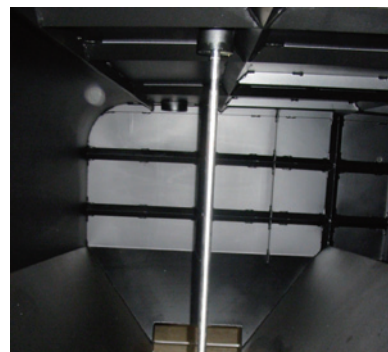
写真-4 タンク内に設置されたレーダーレベル計
