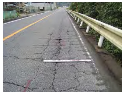
施工前の状況 (ひび割れ率 60%)
