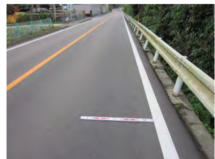
1 年後の状況 (ひび割れ率 16%)
