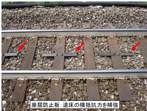
写真-1 レール張り出し対策例 1)
