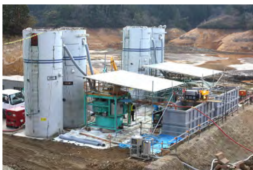
写真-1 固化材スラリープラント (2 組)
