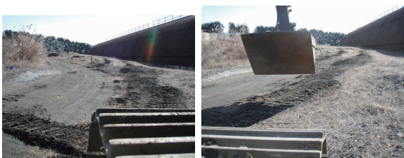
写真-6 前方確認用側方カメラの中継映像
