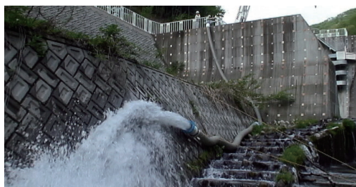
図-7 サイフォンによる排水状況
