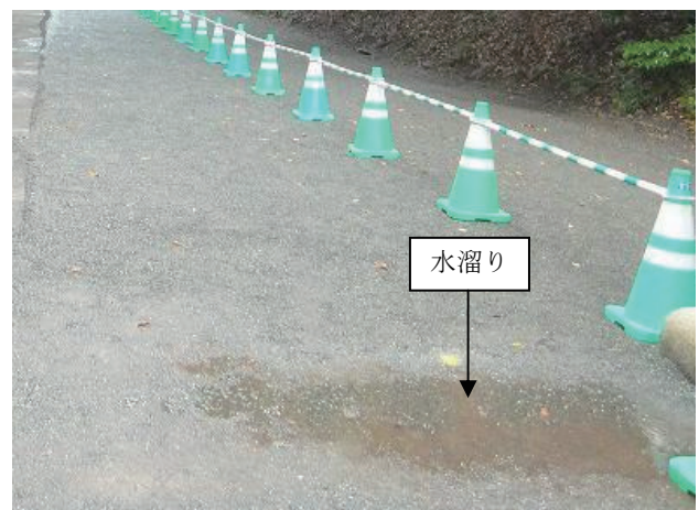
写真-6 施工前・水溜りが発生
