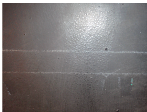
写真-6 裏面の塗膜損傷( t=12\text{mm} )
