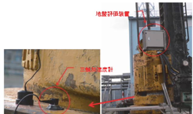
写真-1 地盤評価装置・センサ取付け状況
