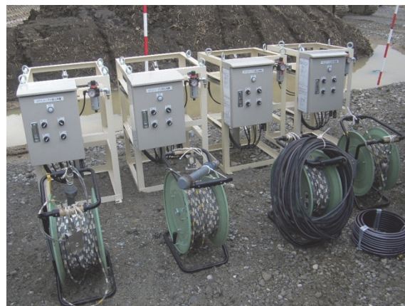
写真-2 自動巻き上げ装置
