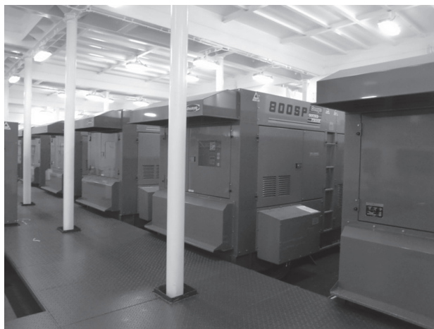
写真-2 可搬式発電機 (800 kVA)
