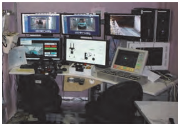
図-8 遠隔オペレータ室
