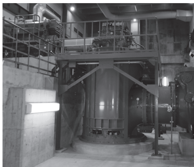
写真-2 立軸ポンプ
