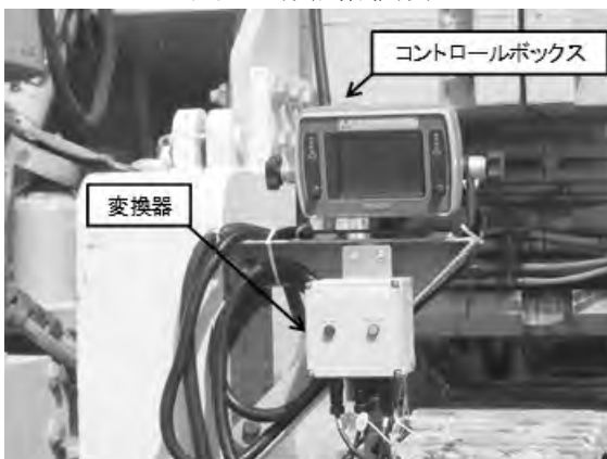
写真-4 コントロールボックス
