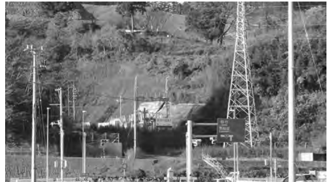
写真-5 特別高圧受変電設備
