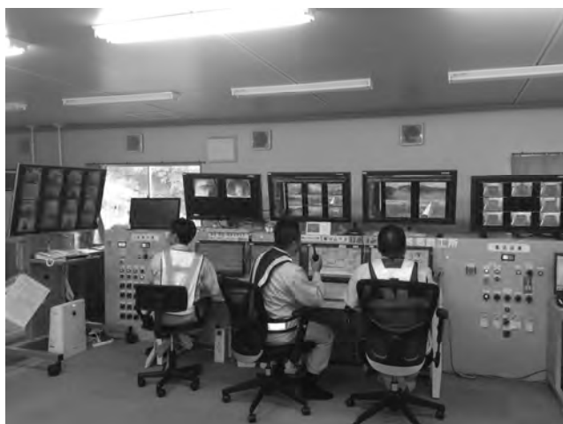
写真-7 中央操作室での制御状況
