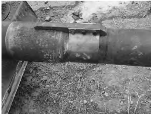
写真-2 ロッドジョイント部のスペーサー
