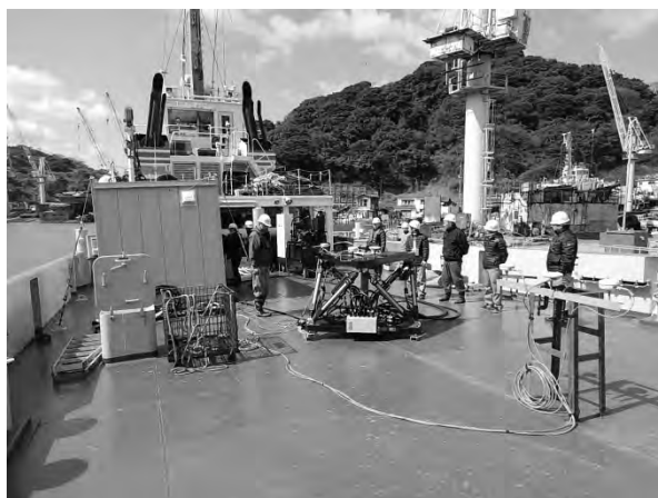
写真-6 機器配置状況
