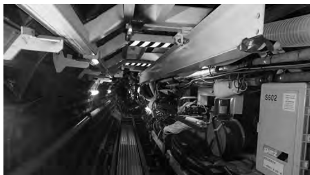
写真-1 セグメントストック装置
