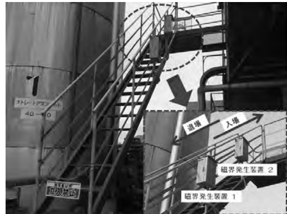
写真-10 出入口に設置された磁界発生装置
