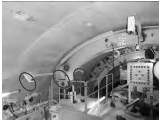
図-9 計測機器設置状況
