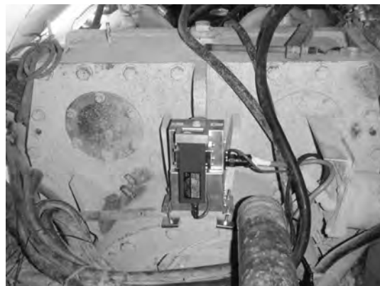
図-12 計測機器設置状況（上側）
