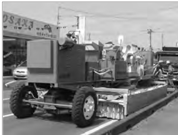
写真-3 路面ヒータ
