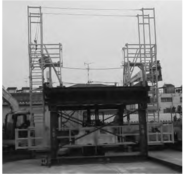
写真-9 ブリッジハンガーの全容
