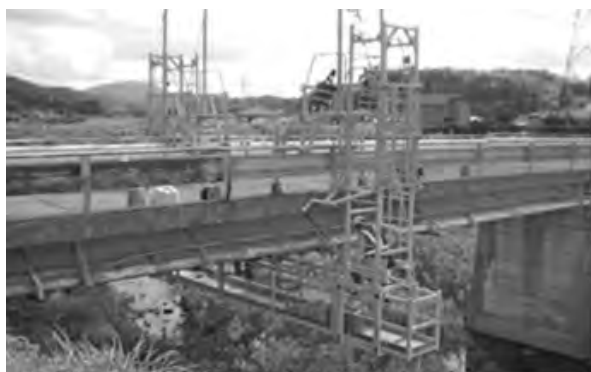
写真-5 35 cm張り出した添架物がある橋梁での状況
