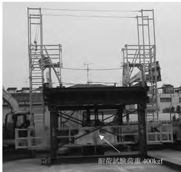
写真-2 ブリッジハンガーの全容
