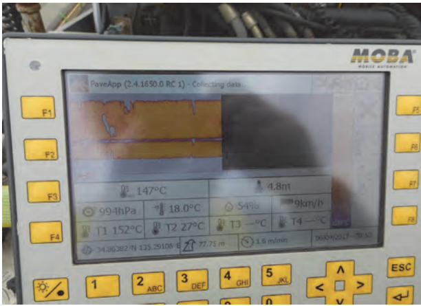
写真-11 敷きならし面管理機器 画面表示
