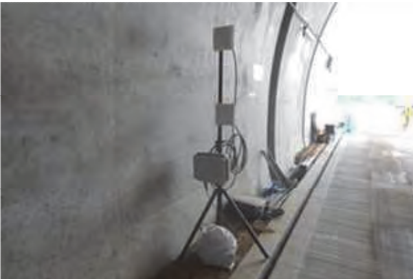
写真-5 可搬型屋外設置用 Wi-Fi 装置
