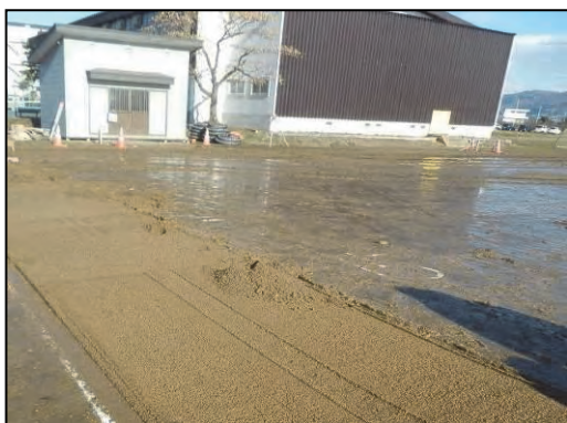
写真-6 改良前・降雨後の状態
