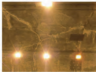
溶脱物の多いスパン
