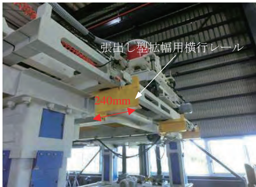
写真-13 張出し型拡幅用横行レール
