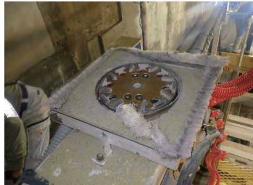
写真-11 粉塵飛散防止枠（ブラシ型）損傷状況
