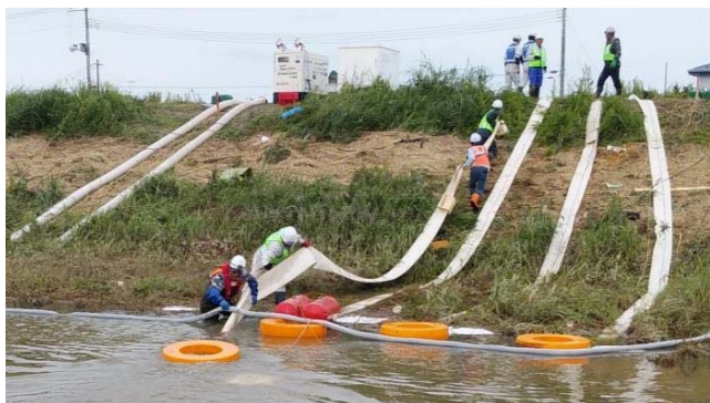
写真-1 排水ポンプ設置状況
