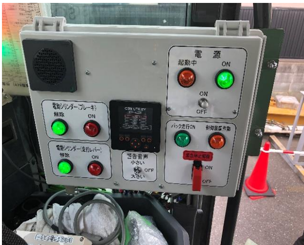
写真-3 ブレーキアシストシステム制御盤
