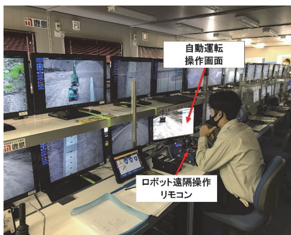
写真-5 操作室状況
