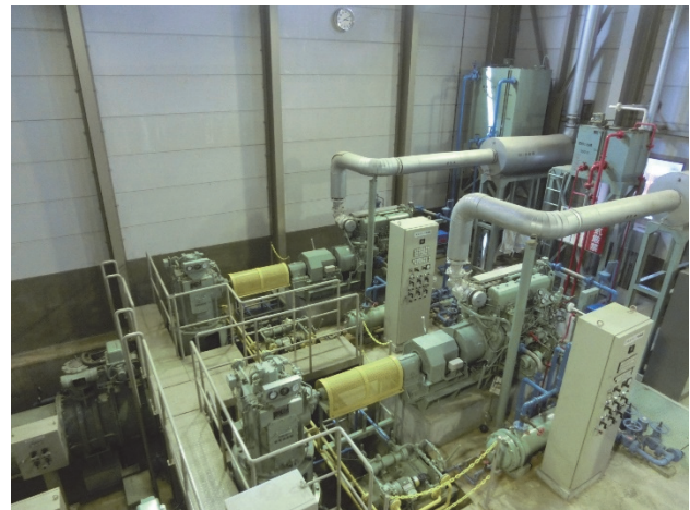
写真-4 赤平排水機場全景(上)と機械設備(下)
