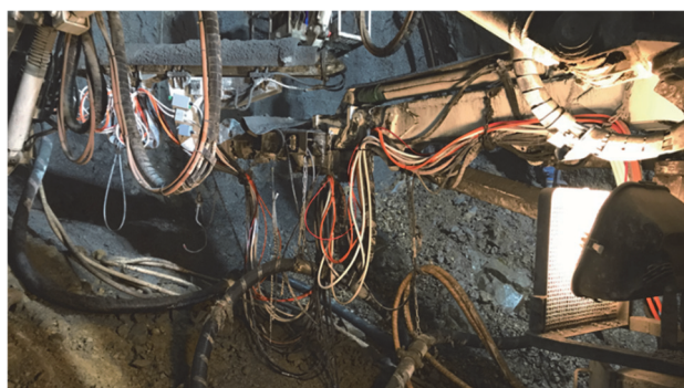
写真-3 配管配線状況
