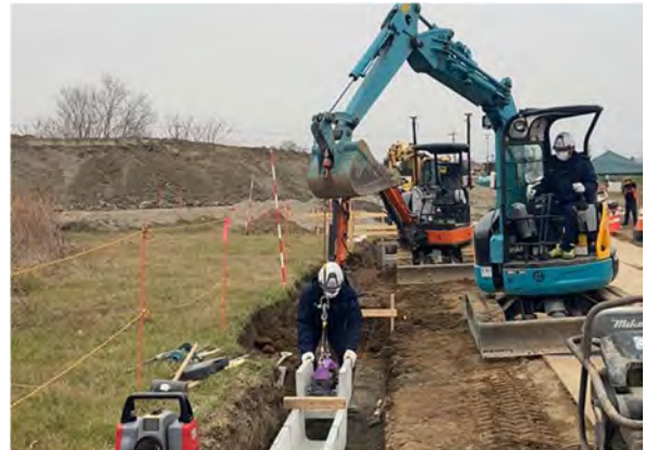
写真-4 排水構造物設置において ICT 施工と従来施工の組合せで施工（排水構造物設置）
