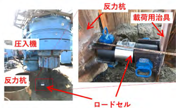
図-7 簡易荷重試験（水平）における荷重計測のキャリブレーションの実施状況
