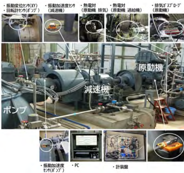
図-2 モニタリングシステム設置事例
