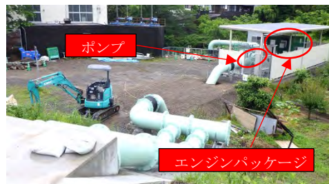
写真-2：四万十市のポンプ設備
