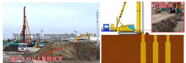
写真-1 盛り上がり土の発生状況例
