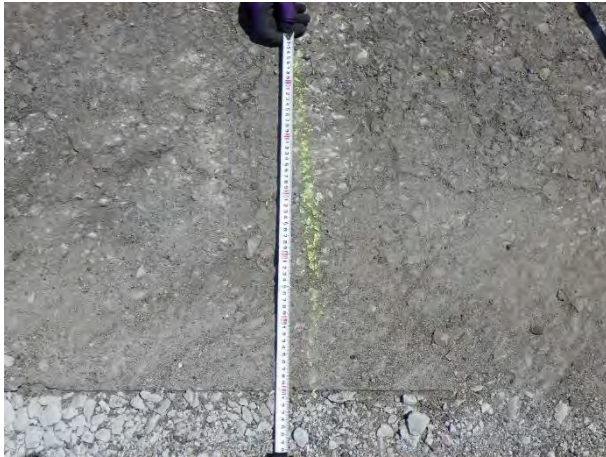
写真-6 舗装上のクラック
