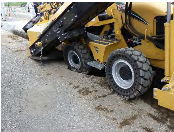
写真-7 掘削肩部での車輪のスタック
